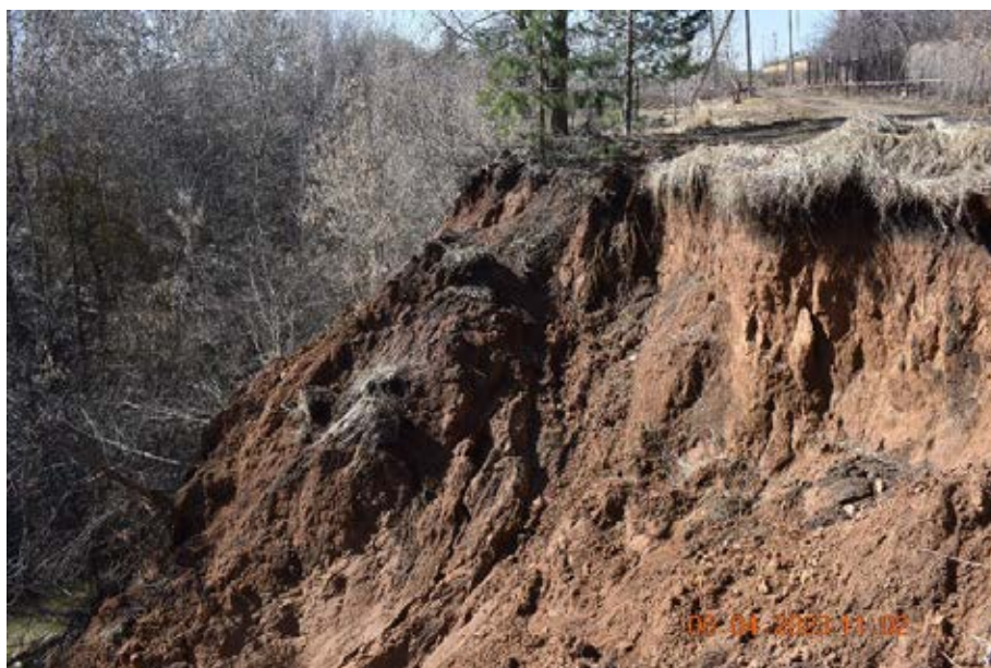
Рис 16.8.16 Правое крыло оползня
