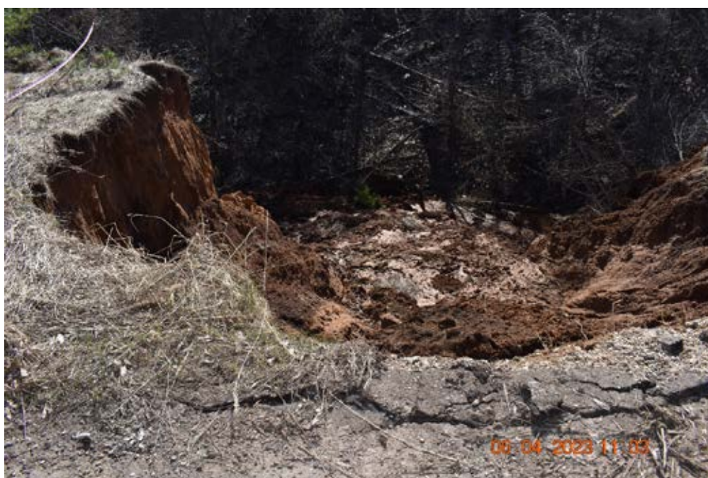
Рис 16.8.18 Трещины отрыва у бровки
