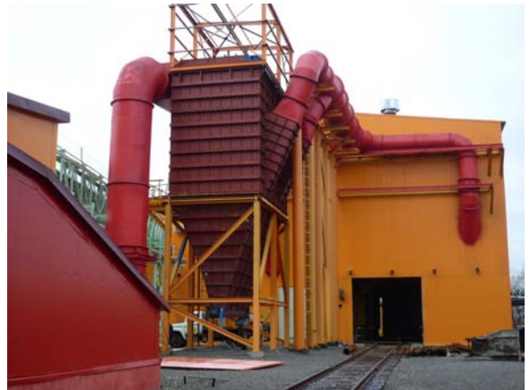
Рис. 4. Взрывозащищенный фильтр INTENSIV, установленный в рамках реконструкции на ОАО «НТМК».
