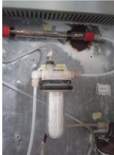
Рис.5. Датчик капельной влаги установленный в корпус фильтра тонкой очистки.
