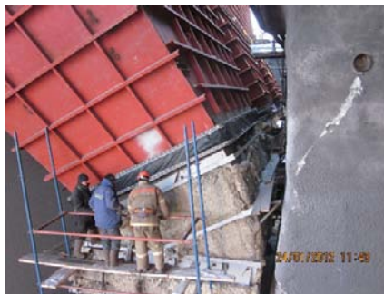
Компенсаторы Электрофильтра ALSTOM
