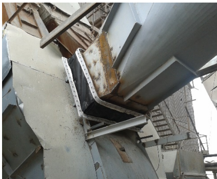
Компенсатор на входе в ЭФ
