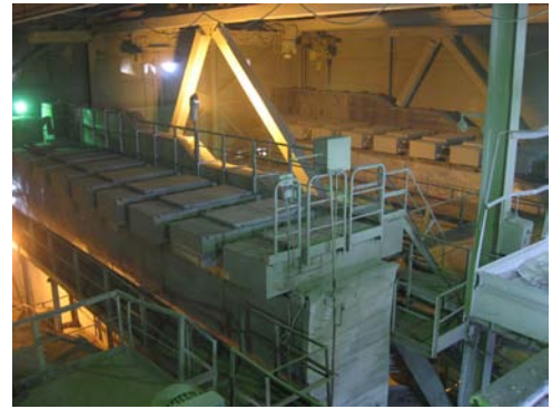
Рис. 3. Фильтр INTENSIV, установленный в рамках реконструкции на ОАО «Невьянский цементник».
