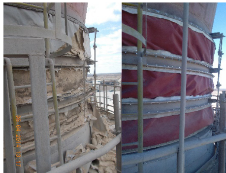
Компенсатор башни охлаждения
