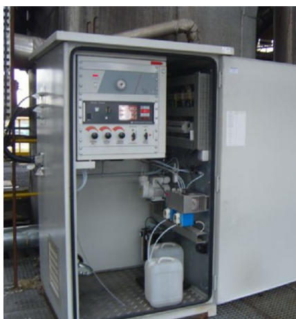
Рис. 4. Система пробоподготовки и анализатор в шкафу.
