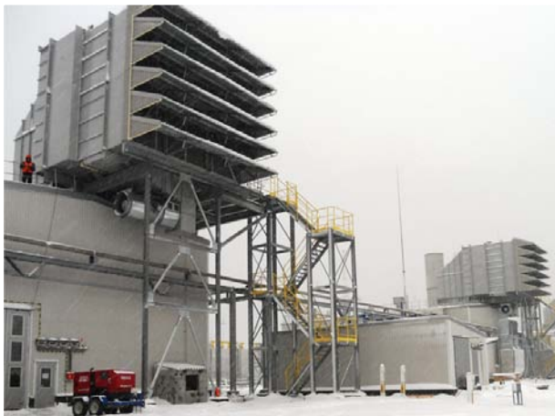
Рис. 5. Воздухозаборные козырьки (импульсное КВОУ с самоочищающимися фильтрами ASC AAF для газовой турбины Trent60 Rolls Royce мощностью 50 МВт. Компрессорная станция «Портовая» магистрального газопровода «Северный Поток».).
