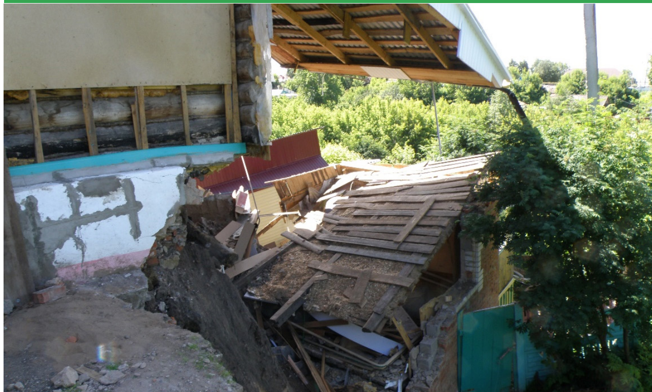
Рис. 16.8.13 Обрушение части дома 53 по ул. Маринина, фото май 2020 г.
