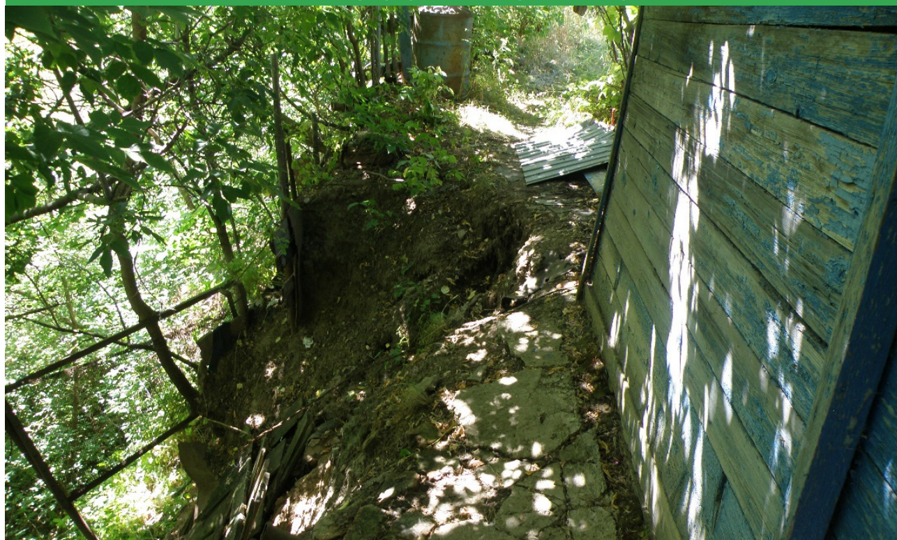
Рис. 16.8.17 Эрозионный уступ у дома 61 по ул. Мало – Пугачевский овраг
