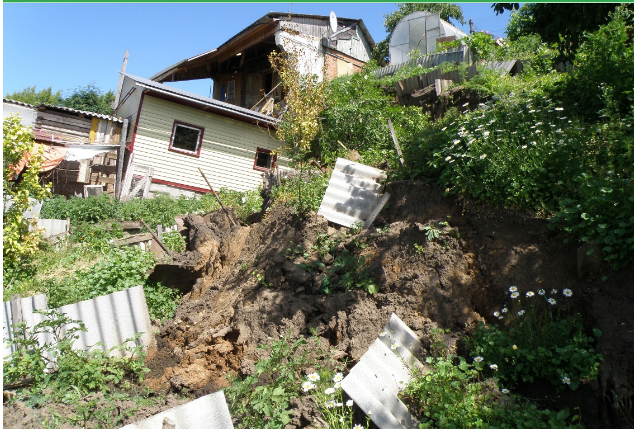
Рис. 16.8.15 Обрушение части жилого дома 53 по ул. Маринина, фото май 2020 г.
