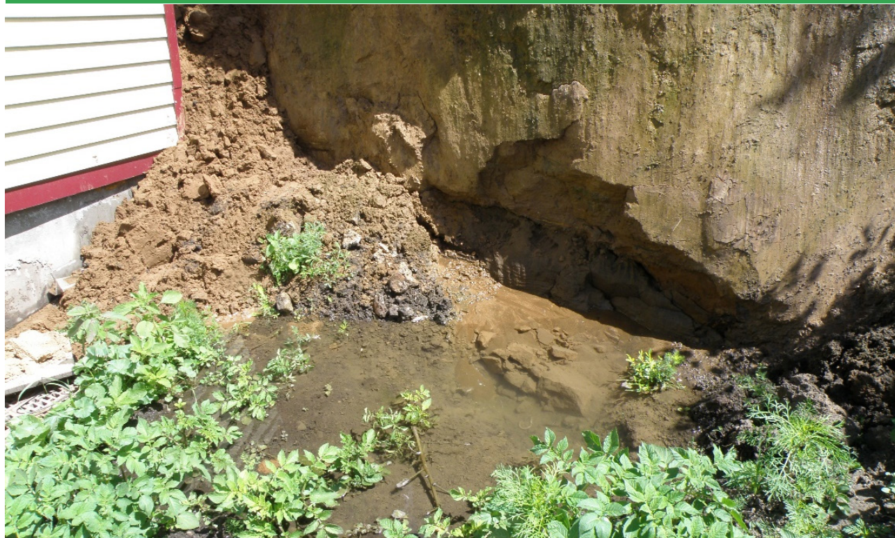
Рис. 16.8.16 Выход грунтовых вод под ступенью оползневого тела.
