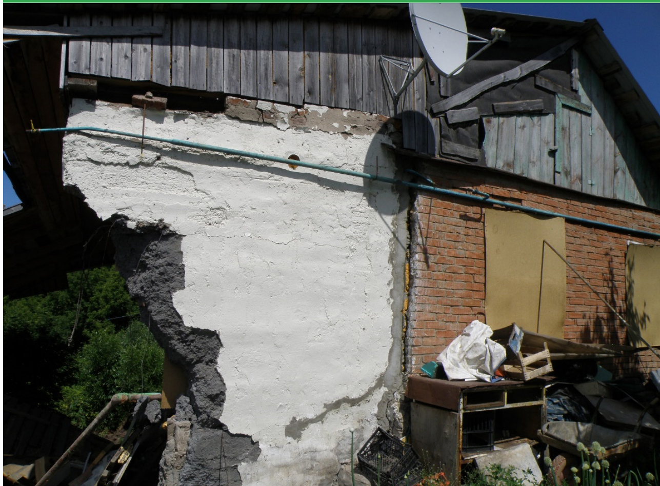
Рис. 16.8.14 Обрушение части дома 53 по ул. Маринина, фото май 2020 г.
